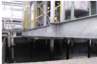
排水処理装置
