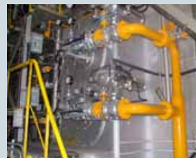
天然ガスボイラー
